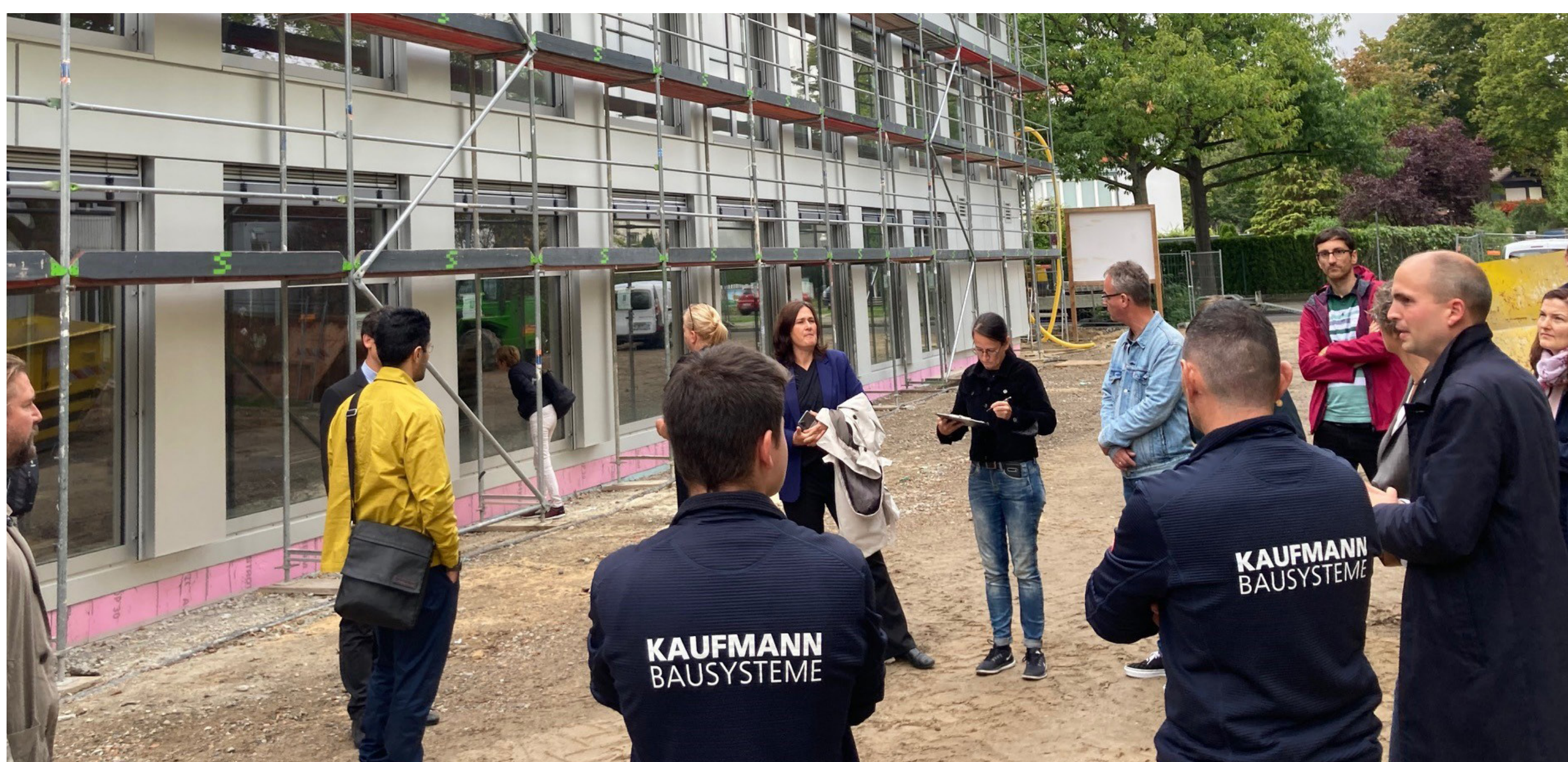
Besichtigung des Neubaus der Theodor-Haubach-Schule in Berlin Lichtenrade Modularer Schulergänzungsbau in Holzbauweise (HOMEB)
